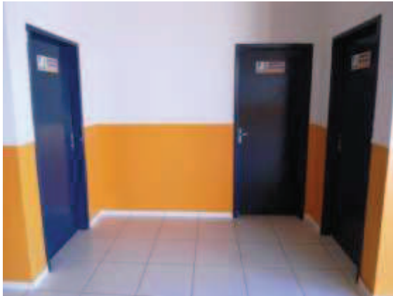
Banheiros feminino, masculino e de acessibilidade do térreo (iguais em medida e estado de conservação aos do pavimento superior)
